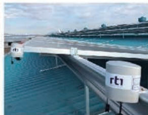
대규모 물류창고 지붕에 설치된 태양광 발전설비
